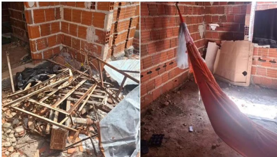
Figura 3 – Escombros de construção em que os 12 trabalhadores resgatados na cidade de Eusébio/Ce
